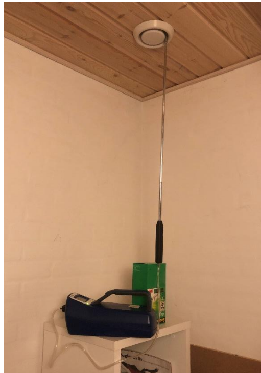
Figur 2: Målinger i indblæsningsluften.
