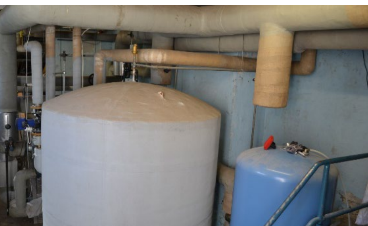
Varmtvandsbeholderen, som skal udskiftes i 2019. De nye cirkulationspumper har en tilbagebetalingstid på 2 år.
