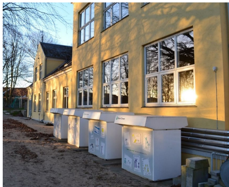
Der er installeret fire varmepumper ved Hylke Skole og Multihus. Det er et kaskadesystem, hvor hver enhed har en effekt på 23 kW.
